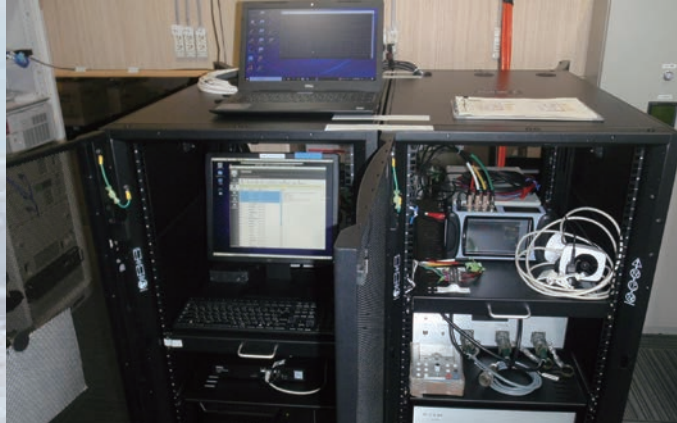
基本観測棟の収録ラック
