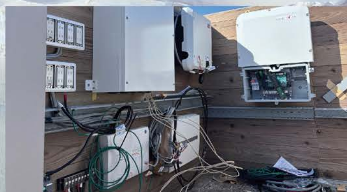
電源切り替えシステム
