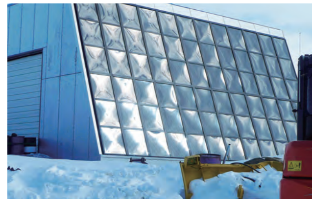
昭和基地の自然エネルギー棟に設置された太陽光集熱パネル
